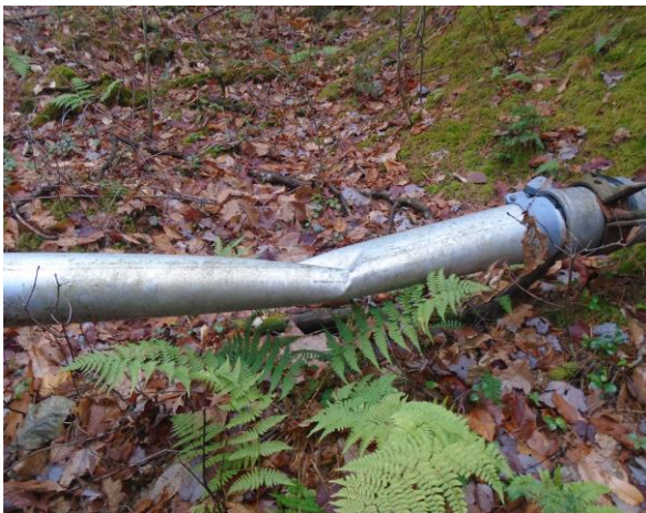
Figure 34 : Bris de la conduite suite à la chute d'un arbre
