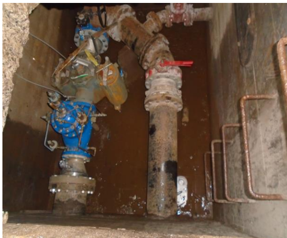
Figure 28 : Intérieur du regard de la chambre de vanne
