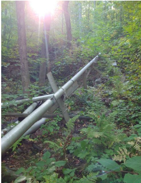
Figure 30 : Conduite de refoulement – Milieu accidenté et installation de support (photo prise le 19 septembre 2019)
