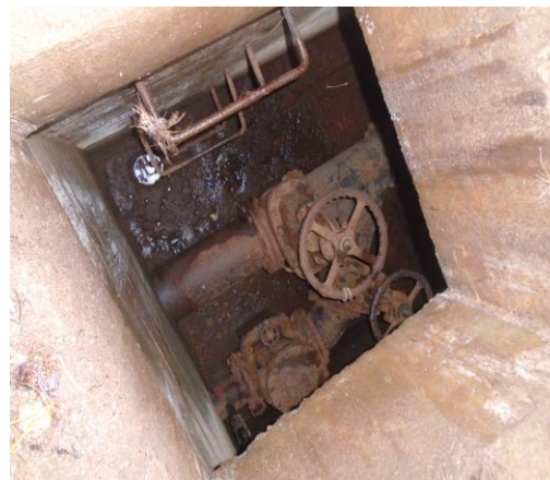
Figure 33 : Trou d'homme abritant la vanne papillon connectant la conduite de refoulement au lac Écho
