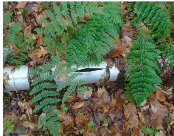
Figure 35 : Éclatement du tuyau suite au gel
